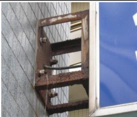
接合部(ブラケットの腐食劣化)
