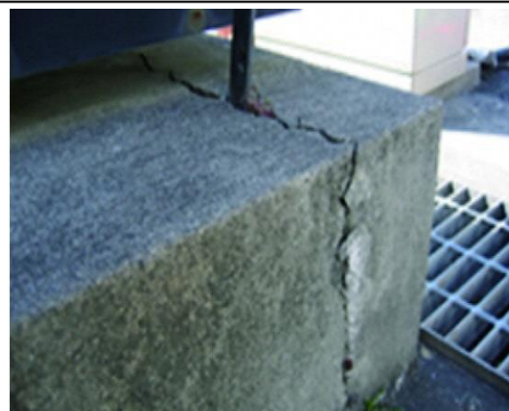
基礎部(基礎のクラック)
