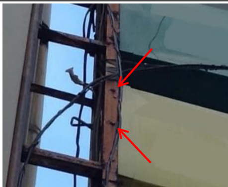
取付部(ボルトのゆるみや欠落)
