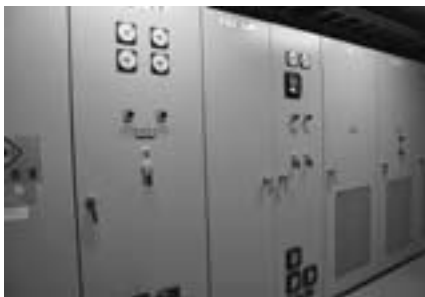
▲高圧受電設備
