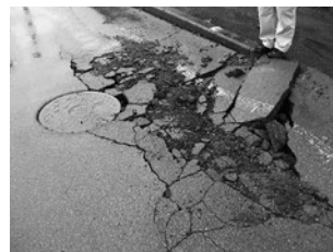
(水圧による舗装等の破損)
